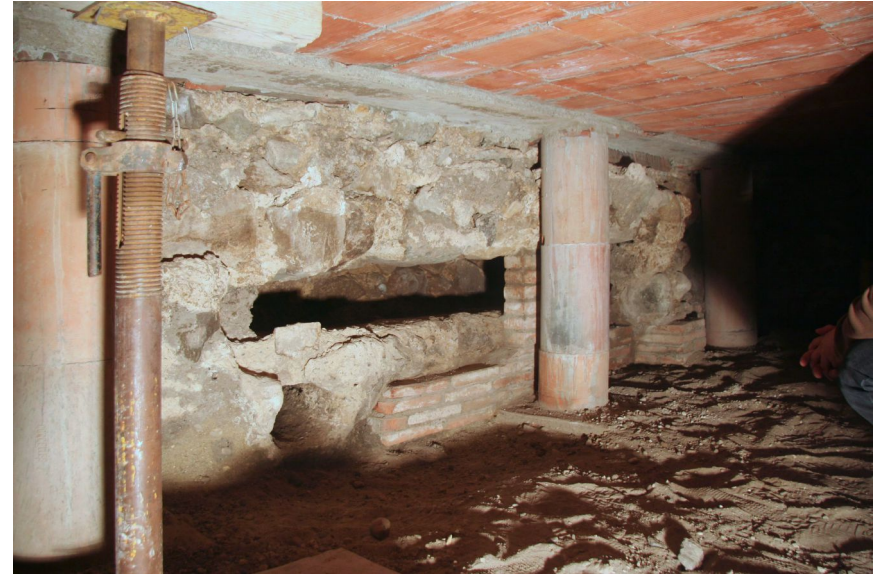
Fondations affaiblies par les concavités et les interventions archéologiques
