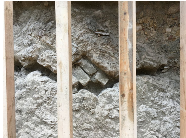
Fissuration d'une voûte due à la déformation de la façade nord
