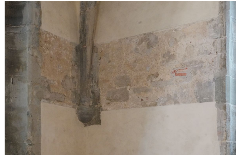
Les restes d'enduit de 1398 dans la chapelle d'Estavayer.
